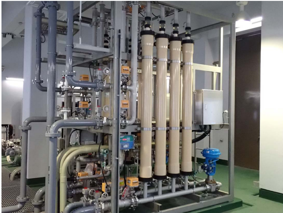
矢立浄水場 膜ろ過設備
